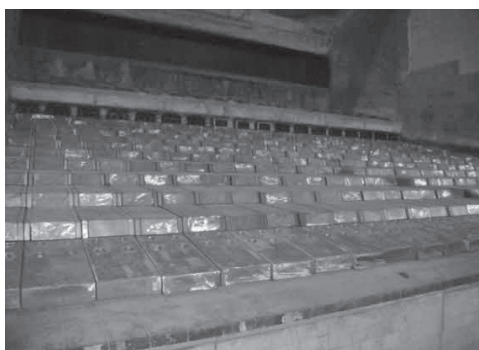
焼却炉内部の火格子
