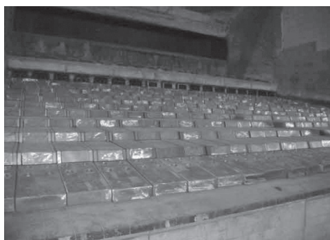
焼却炉内部の火格子
