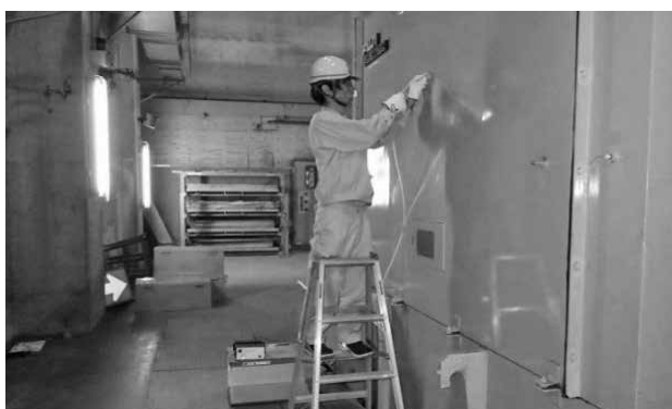
(写真3) 蒸気タービン発電機でのオゾン濃度測定
