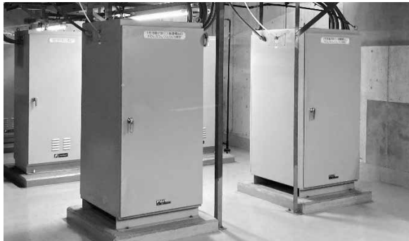
排ガス分析計（板橋清掃工場）
