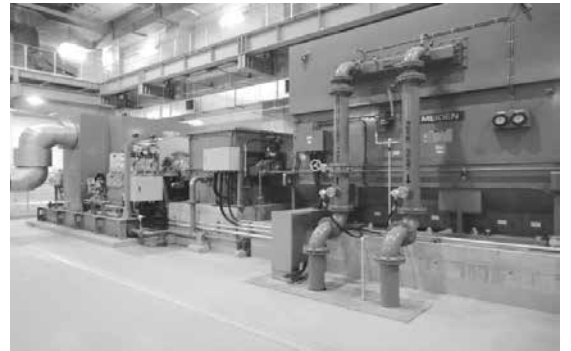
蒸気タービン発電機（光が丘清掃工場）
