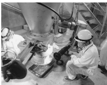
装置を分解し清掃している様子
