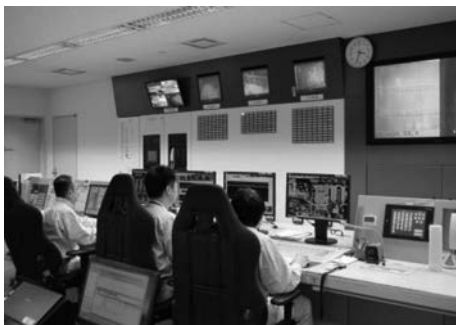
中央制御室で各設備の運転操作と監視を行います
