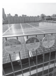
屋上に設置した288枚の太陽光発電パネルは、区有施設で最大規模
