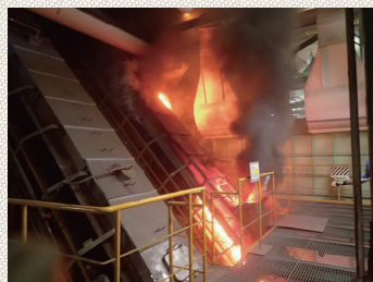
不燃ごみ処理センターの火災（令和2年11月21日）
