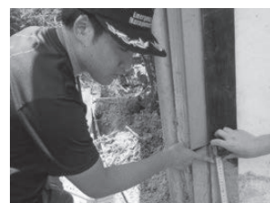
▲派遣した職員による被害状況の調査
